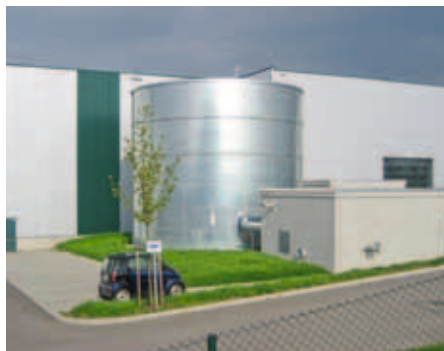
Wasserbehälter mit 630 m 3 Rauminhalt für die netzunabhängige Löschwasserversorgung im Prologispark im GIK.
