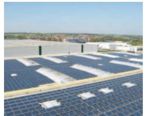
Blick über das Dach der Fa. Landerer mit der Photovoltaikanlage. Daneben die Hallen der Fa. Prologis, im Hintergrund die Gemeinde Hardthausen - Ortsteil Gochsen.
