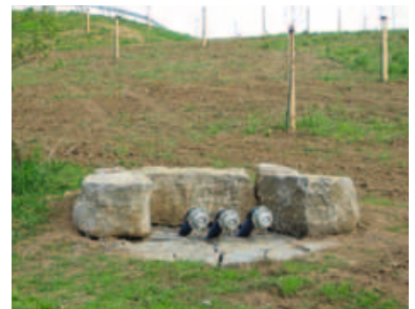
Einspeisestelle für Löschwasserversorgung aus öffentlichem Gewässer, (hier: nahe dem Bach Brettach) mit drei B-Leitungen.
